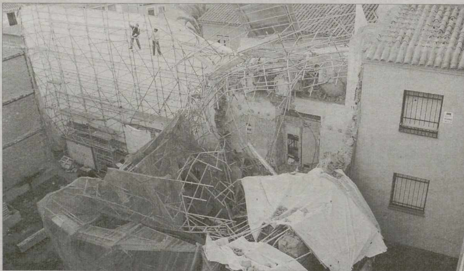
Al final se ha tenido en cuenta la tesis de IU para retirar el nivel P ante los reiterados daños que ha sufrido el edificio del Juego de Pelota. / Y. LANCHIA
