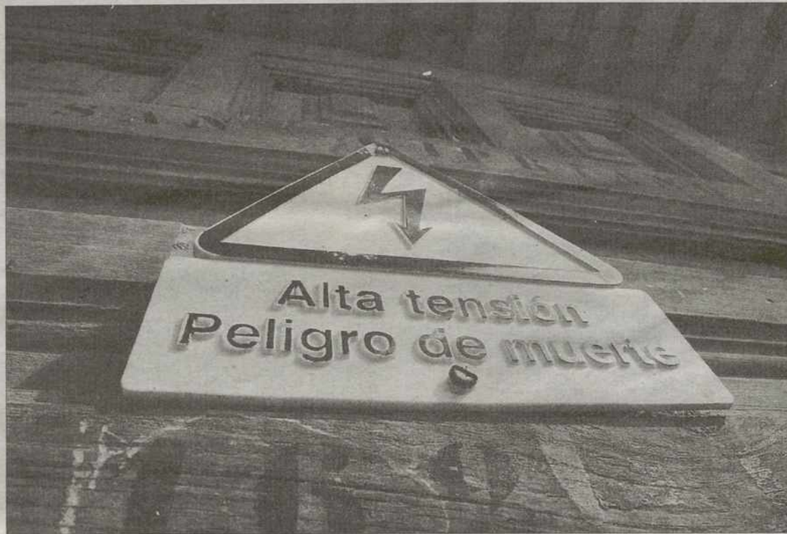
Los carteles de peligro por transformador eléctrico aumentan, en lugar de desaparecer./VALDIVIELSO
