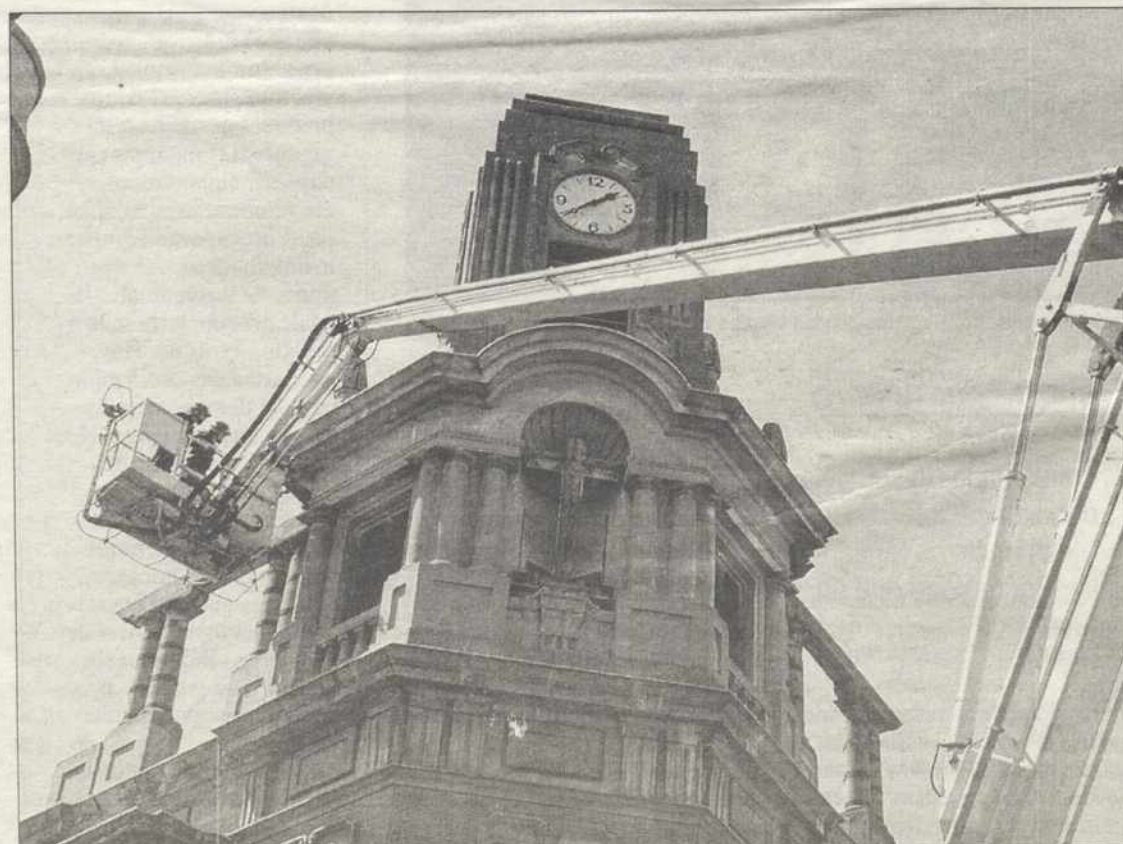
Los bomberos utilizan el brazo articulado para retirar cascotes y evitar más desprendimientos
