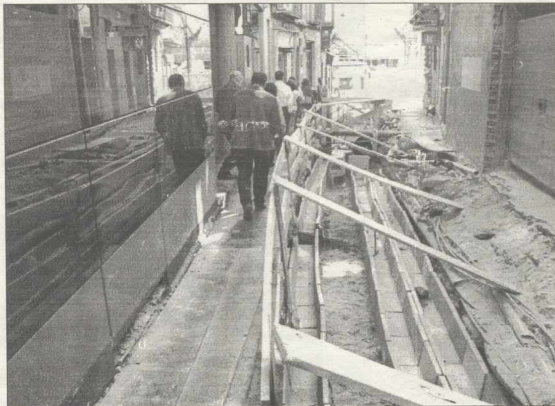
Critica que, después de las molestias por las obras, éstas se hayan quedado sin finalizar
