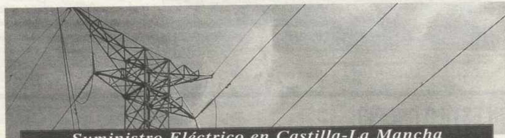
Suministro Eléctrico en Castilla-La Mancha
