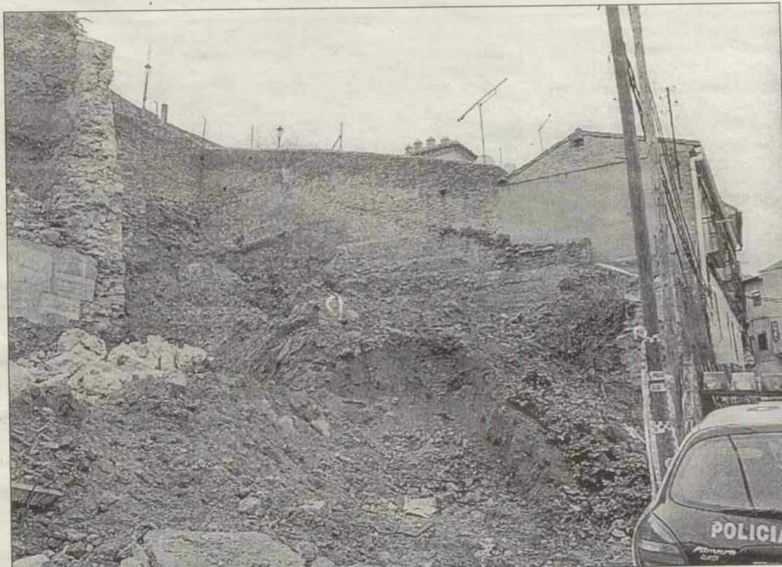
Esta es la zona en la que se ha roto el precinto y se ha sacado tierra dejando el muro al aire
