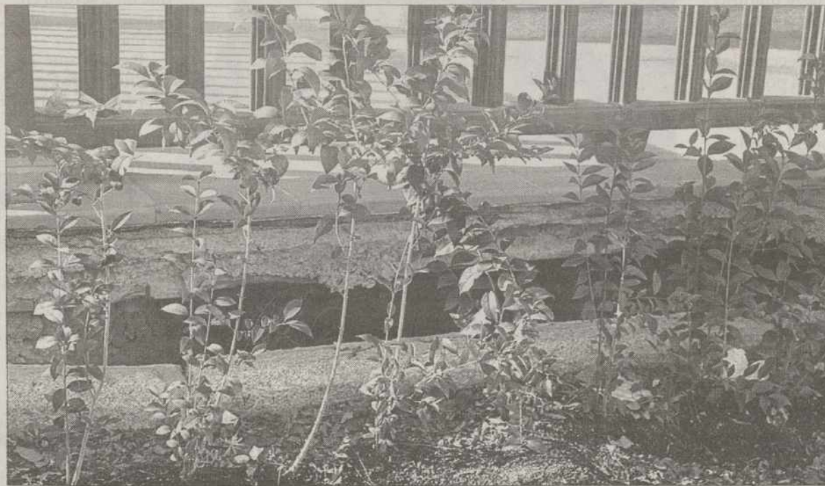
Esta grieta descubre el hueco donde están los pilares de contención del edificio.
