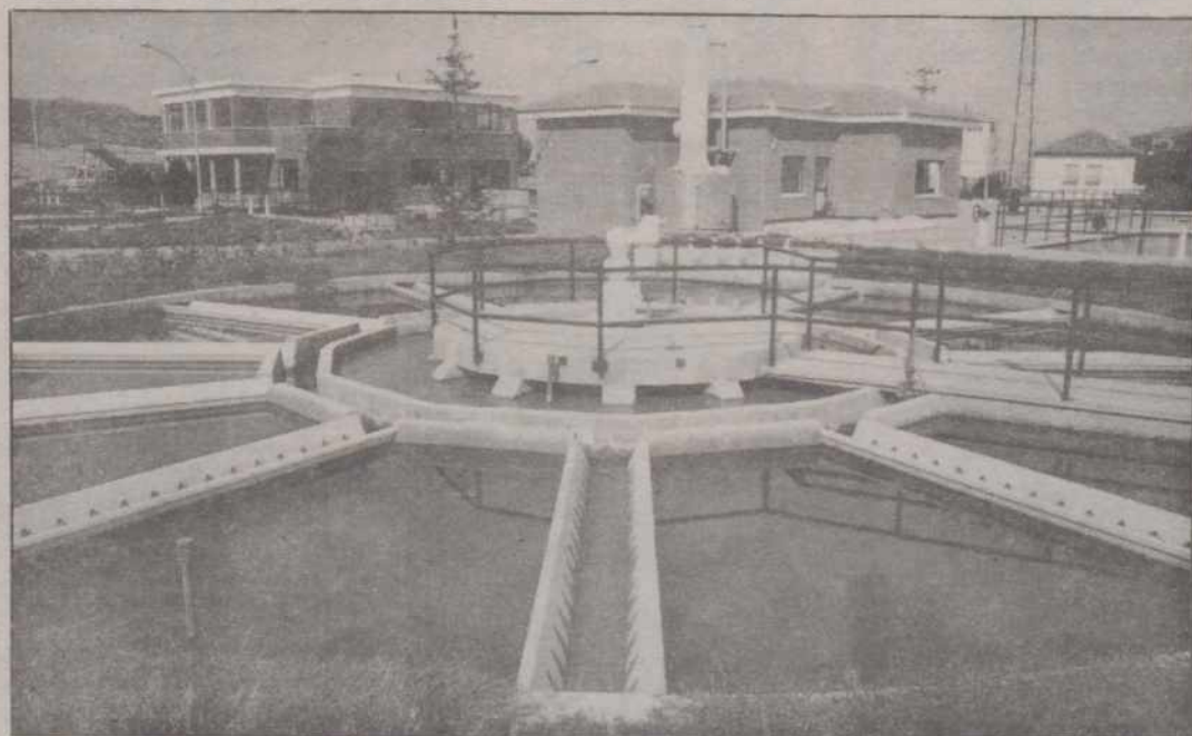
En primer término uno de los decantadores
