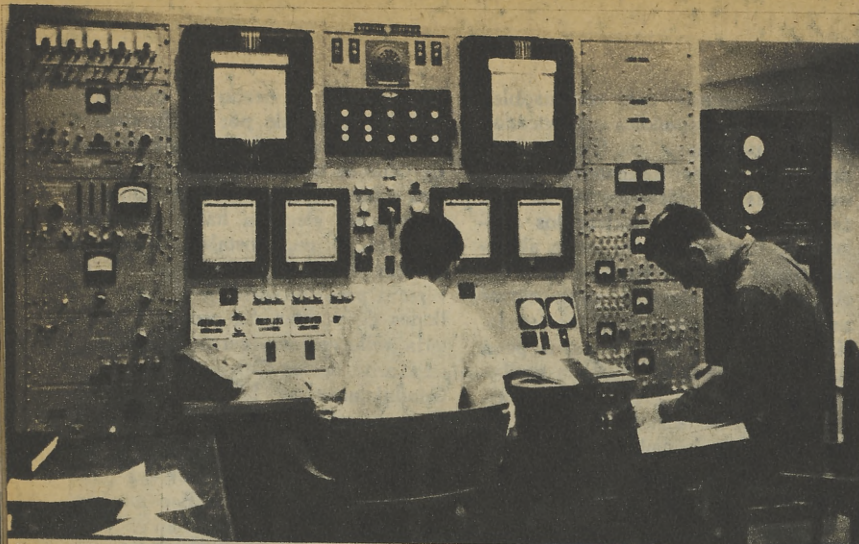
Puesto de mandos de un reactor nuclear español en funcionamiento.
