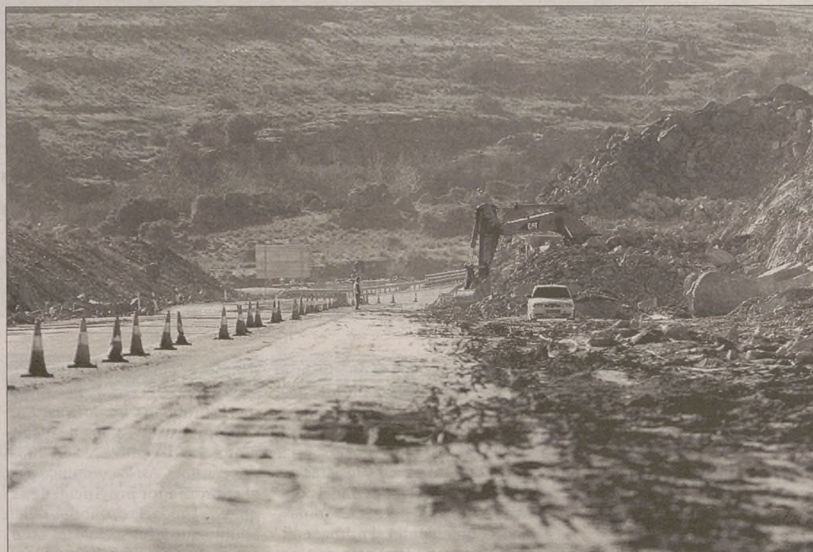
Desmante para la duplicación de la calzada junto al puente de Fuentes Claras. / DAVID CASTRO
