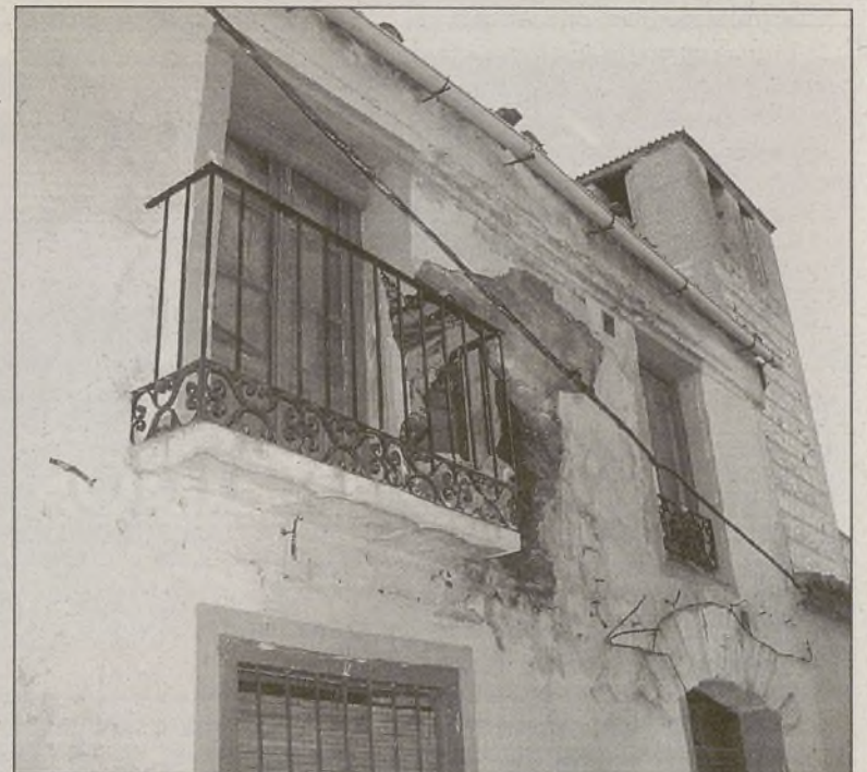
Estado actual de la fachada tras el derrumbe / M. M. E.
