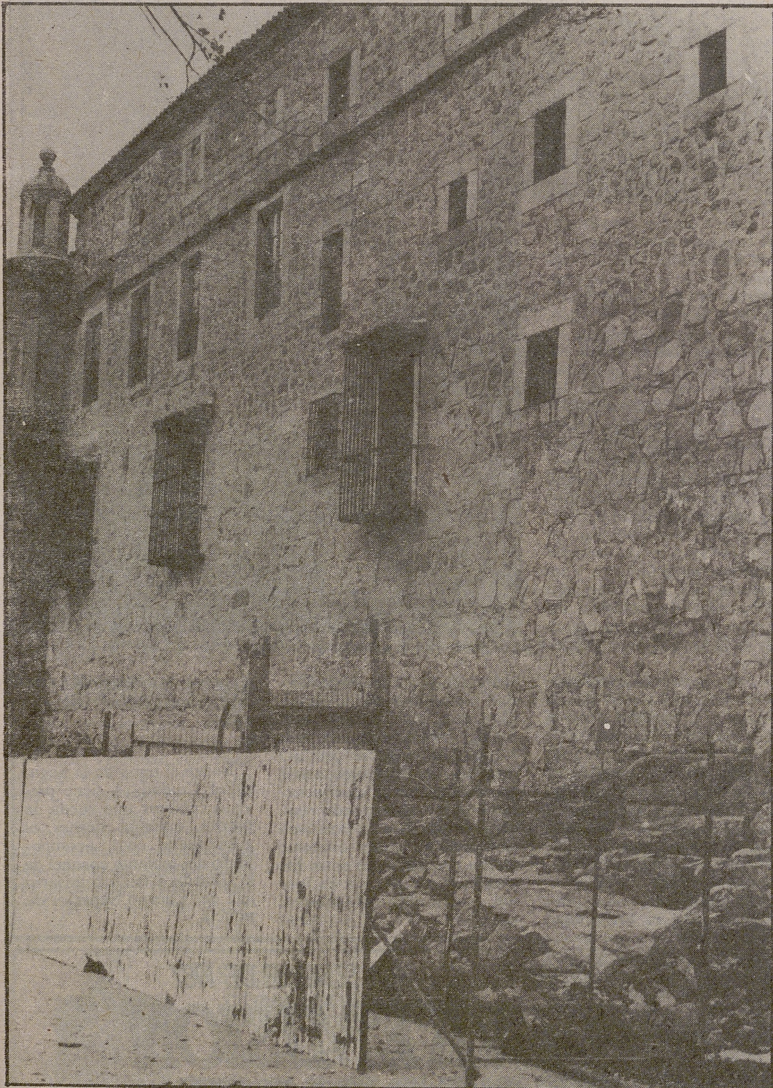
En la pared del Obispado, a una altura no pequeña, se observa el abombamiento de la piedra.
