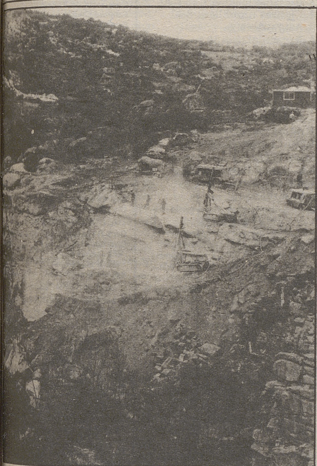
En este lugar se asentará el muro de la presa de Mingorría LUMBRERAS
