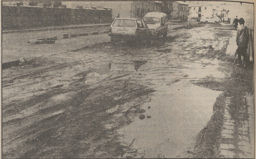
Las interminables obras de Jesús del Gran Poder, iniciadas el pasado verano, originan barrizales como éste. LUMBRERAS
