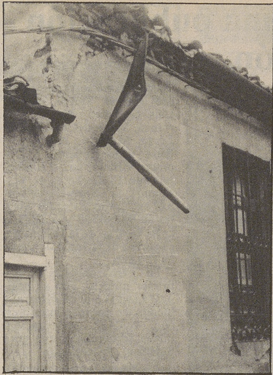
Los canalones, corroídos por la humedad, cuelgan amenazados con caerse
