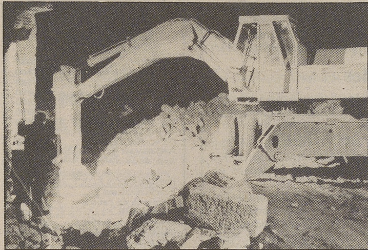
Potentes máquinas se utilizaron para remover la parte de muro caída LUMBRERAS
