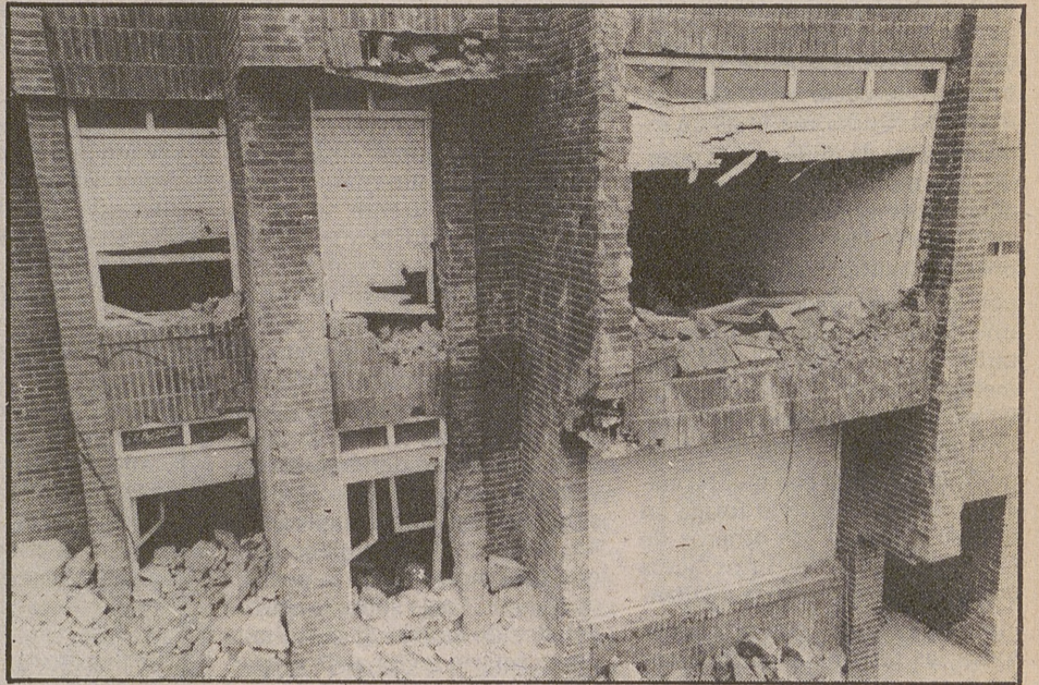
El edificio existente frente al muro sufrió graves daños.
