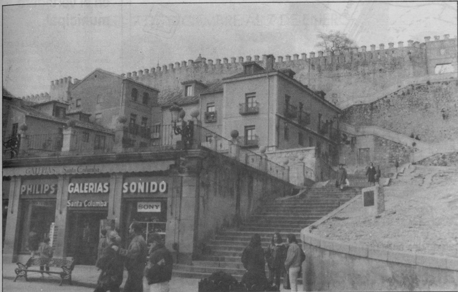
La séptima fase de la rehabilitación de la muralla afectará a todo el muro incluido dentro de la Huerta del Seminario.
