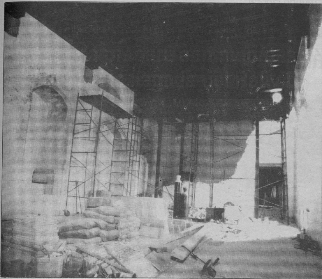
Las obras en las nuevas salas del Real Colegio de Artillería van a buen ritmo
