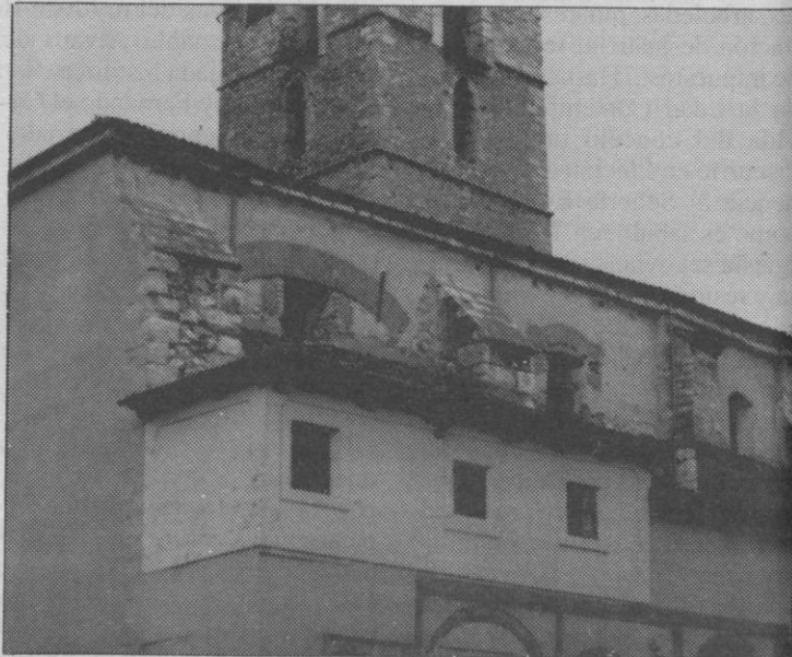
La iglesia de San Miguel sufre un importante deterioro.
