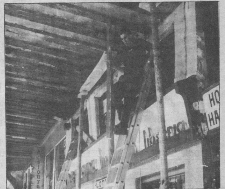
Se quieren evitar riesgos, como una caída de la marquesina.
