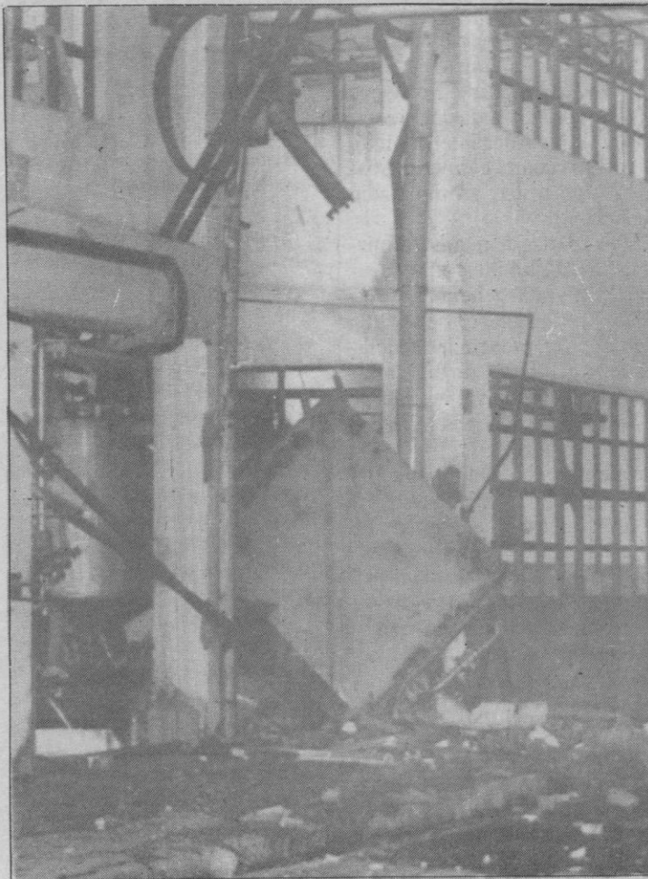
Parte de los destrozos causados tras la explosión.
