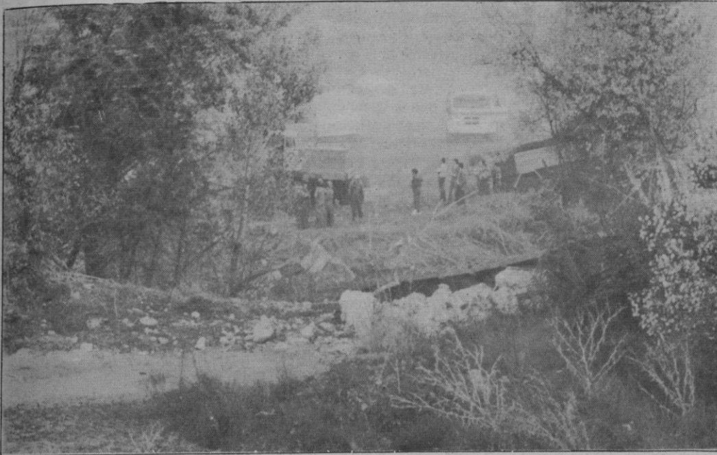
Voladura de un puente por la Diputación Provincial para el ensanche de una carretera. (Foto: Aurelio Martín)
