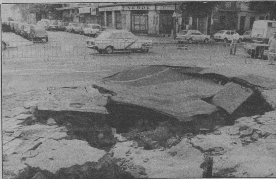
Madrid.— Un socavón de unos 20 metros de diámetro se ha producido en la calle Virgen de Nieva, esquina a la de Bravo Murillo, enfrente de las cocheras del «metro» de Cuatro Caminos. El citado socavón, de unos tres metros de profundidad, ha afectado a las conducciones de agua, gas y electricidad, y parcialmente, a la circulación de vehículos por la transitada calle de Bravo Murillo. El socavón fue inmediatamente vallado y debidamente señalizado por la Policía Municipal, en evitación de posibles accidentes. (Foto-Efe)
