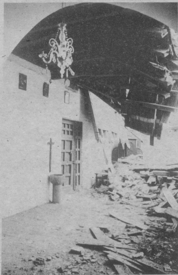
Vinaderos (Avila).— Destrozos en la iglesia de la localidad tras el derrumbamiento de toda la techumbre del templo, cuyos escombros cayeron en su mayoría sobre el cementerio contiguo. Afortunadamente se salvó la imaginería de la iglesia, entre ella un San Gregorio gótico y un Cristo románico. (Foto Efe).
