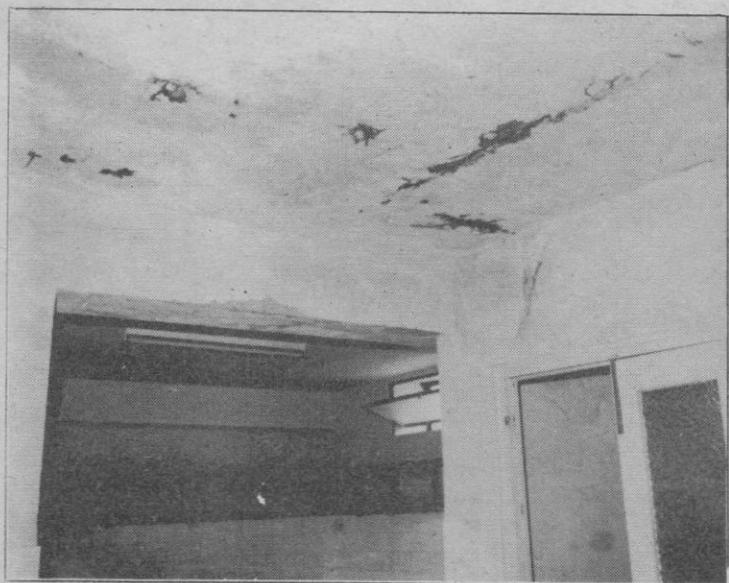
El techo: Una gotera continua
