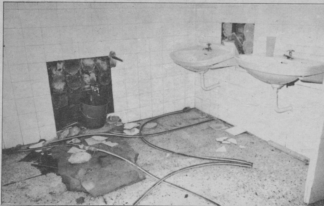
Aseos arrancados, paredes deterioradas, basura por doquier (Fotos: Aurelio M.)
