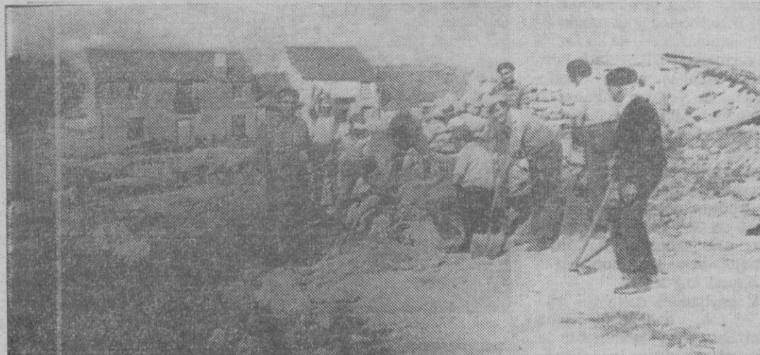
El alcalde de Mata de Quintanar, don Justino Sanz Alonso, trabaja junto a los demás vecinos en la localización de las averías que presenta la conducción de agua potable.
