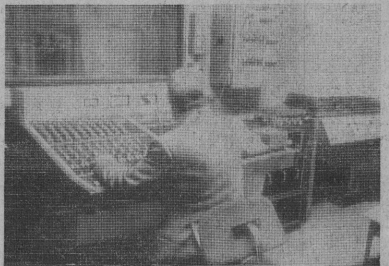
Vista de la sala de control
