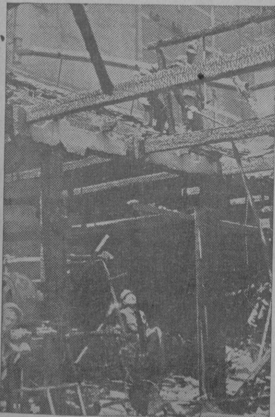
IMPORTANTE INCENDIO EN MADRID.—Vista de la fábrica de algodón de la calle Francisco de Ricci de Madrid después del violentísimo incendio que desde los primeros momentos adquirió gran incremento. Las pérdidas se calculan en unas cien mil pesetas.
