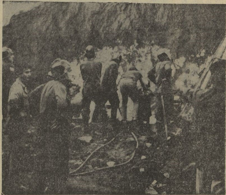
Los bomberos intentan rescatar los tres obreros, de identidad todavía desconocida, que han sido sepultados por un derrumbamiento de tierras ocurrido en las obras del Metro, en Barcelona. (Telefoto Europa Press.)
