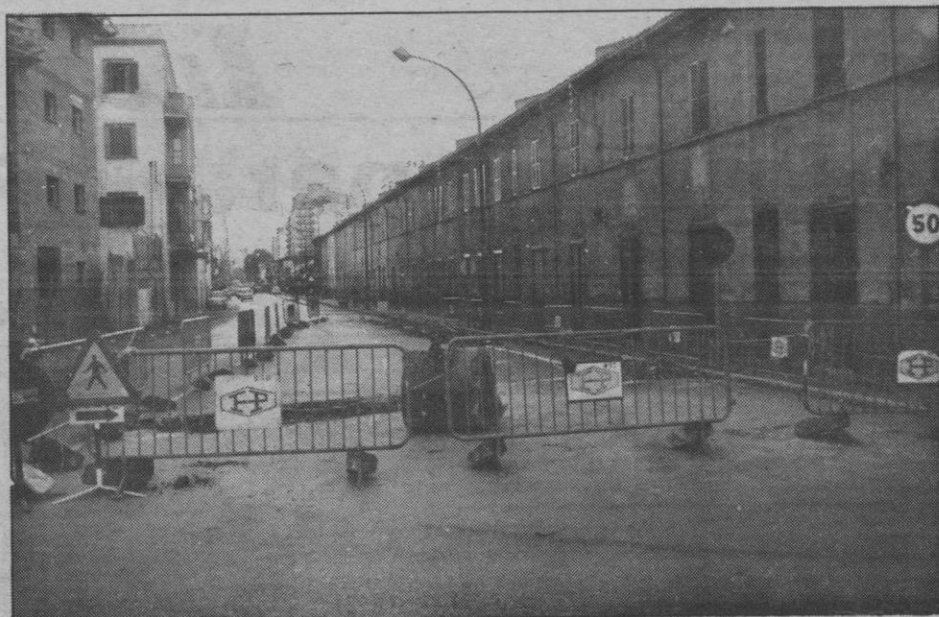
Hoy comienzan las obras en la calle Manacor. Ayer ya se había cortado el carril de penetración a Palma (Foto Delphi)
