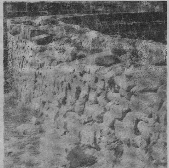
Los pretilos que sobre los baluartes diseñan el foso, acusan asimismo haberse abierto. Sin una causa aparente, las piedras caen.
