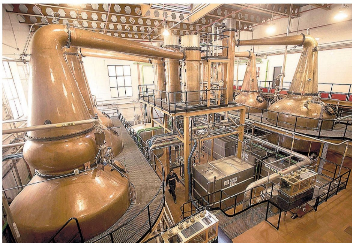
Interior de las instalaciones de DYC en Palazuelos de Eresma, donde se destila el alcohol.
