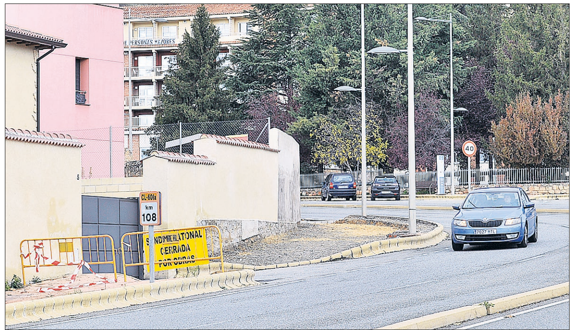
Los trabajos se están llevando a cabo estos días en las proximidades de la Residencia Mixta. / KAMARERO
