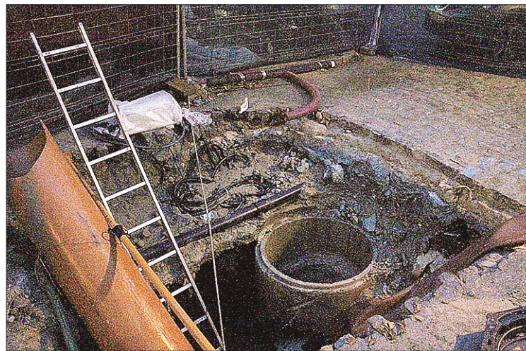
En la foto de arriba, operarios de FCC completan la limpieza de la plaza tras la inundación. Abajo, la zona del colector en la que se produjo la avería. / M.G.
