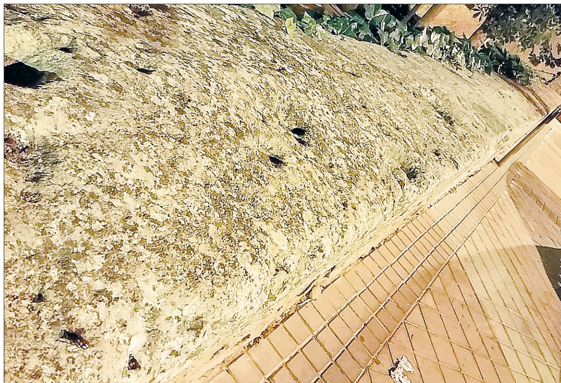
La piedra del pretil que bordea la plaza principal de este barrio segoviano muestra huecos y grietas. / E. A.
