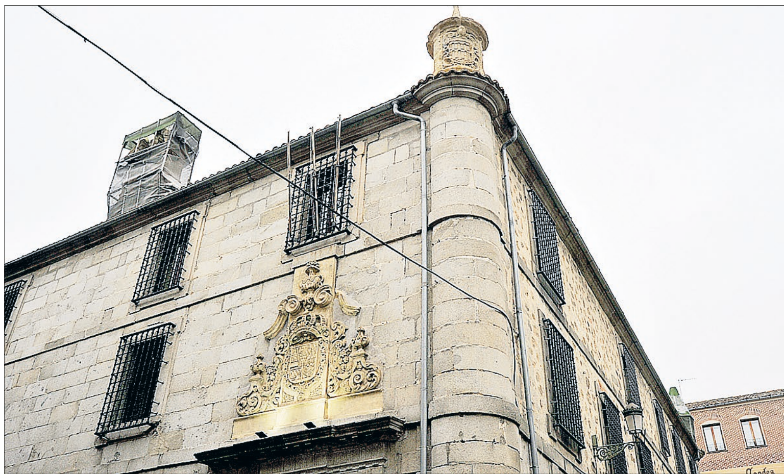
Los pináculos y la espadaña serán restaurados en el plan de rehabilitación previsto en el proyecto. / KAMARERO
