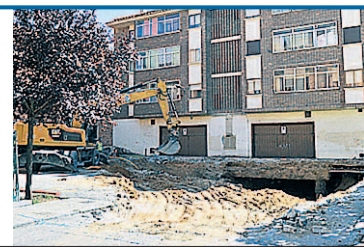
Imagen del socavón frente al edificio de la plaza Aurelio Hernández
