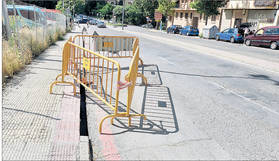
Vallado colocado sobre el último socavón de este tramo del paseo, a la altura del aparcamiento de autobuses. / KAMARERO
