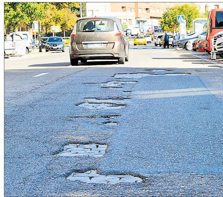
Baches en el pavimento de la carretera de Villacastín. / KAMARERO
