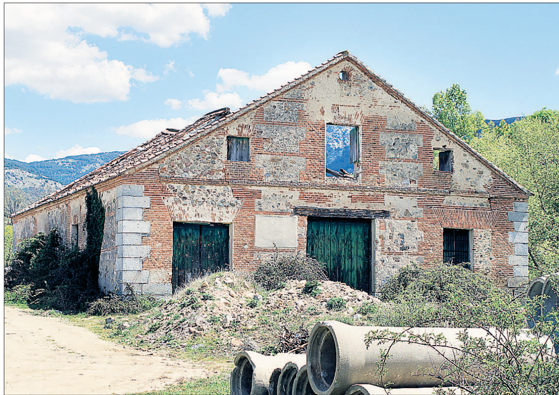
La Casa del Pulimento, junto al puente de entrada a La Granja, perdió su techo en las últimas nevadas. / L. SANZ
