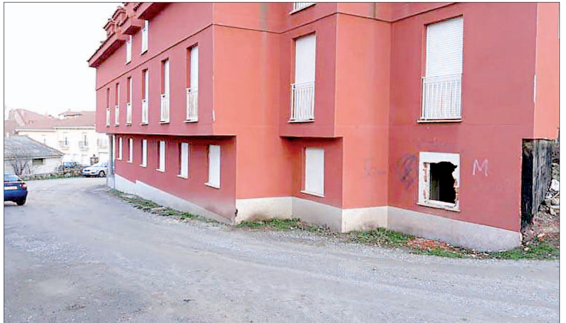
Estado actual de una de las calles que se proyecta pavimentar. / EL ADELANTADO
