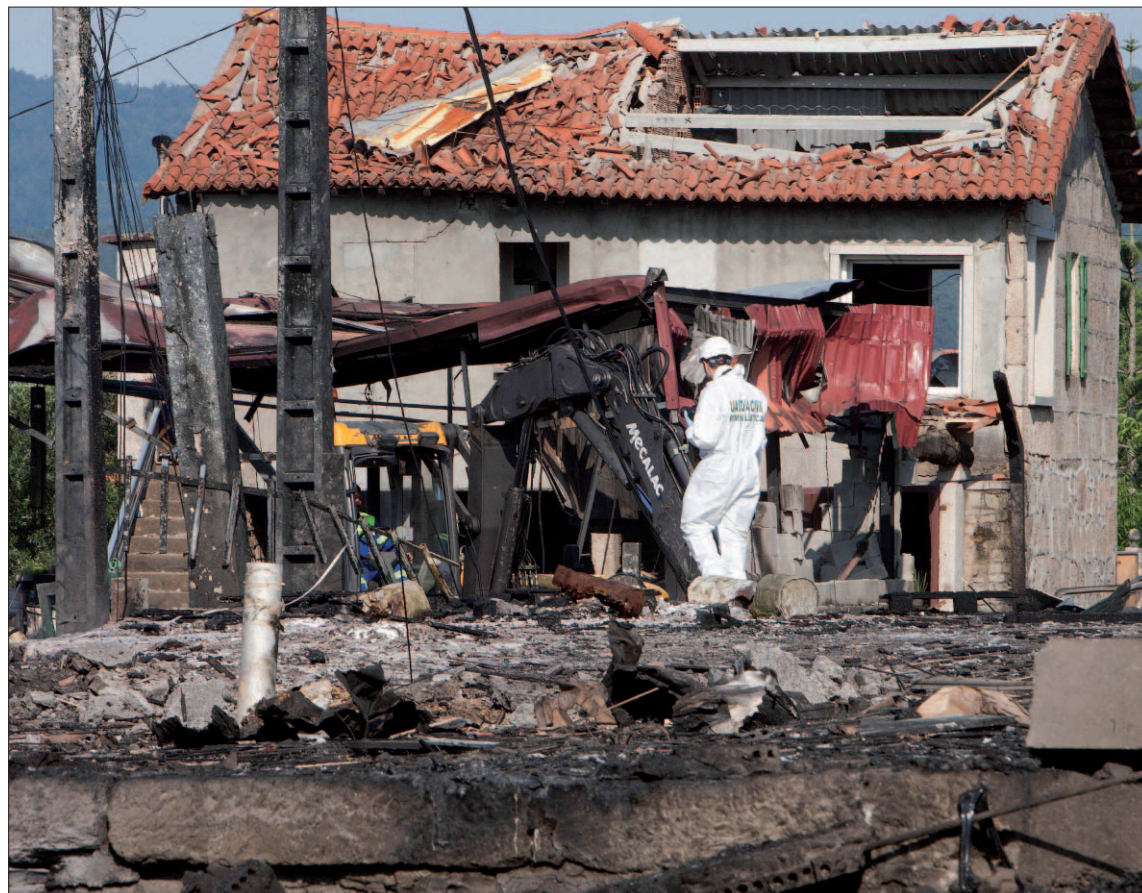
Equipos de desactivación de explosivos y desescombro trabajando en una parroquia de Tui. / EFE
