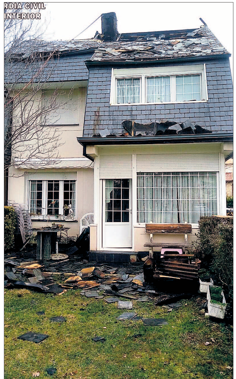
Estado en el que quedó la vivienda incendiada en Riaza. / EL ADELANTADO
