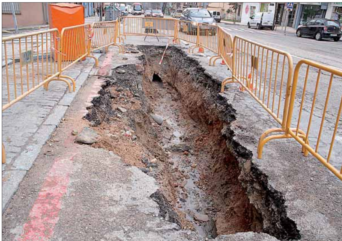
En la calle Ezequiel González es visible el socavón abierto debido a la rotura de una tubería de saneamiento. / N. LLORENTE
