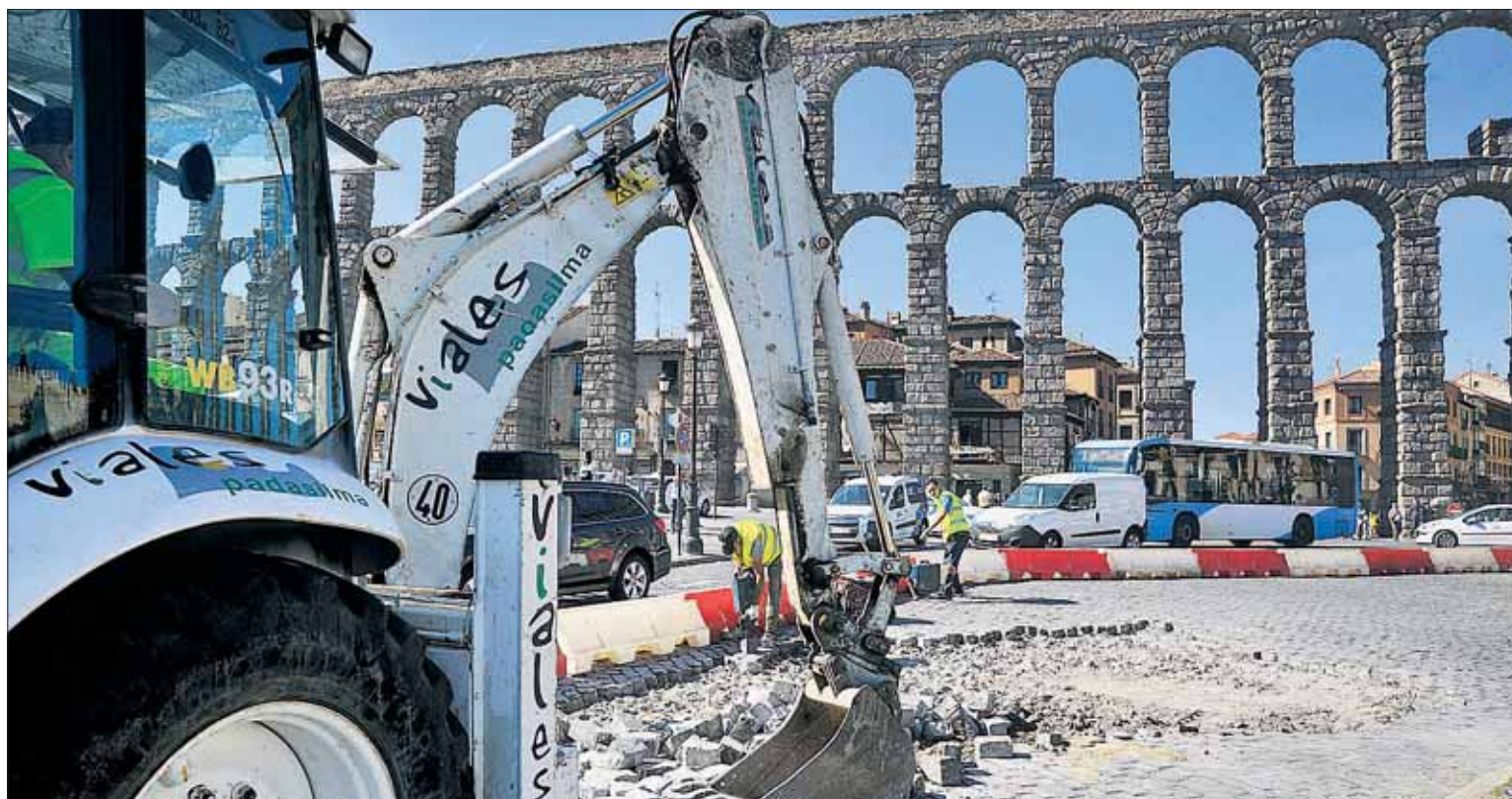
Una excavadora comenzó ayer los trabajos junto a la parada de autobuses de la plaza de la Artillería. / KAMARERO
