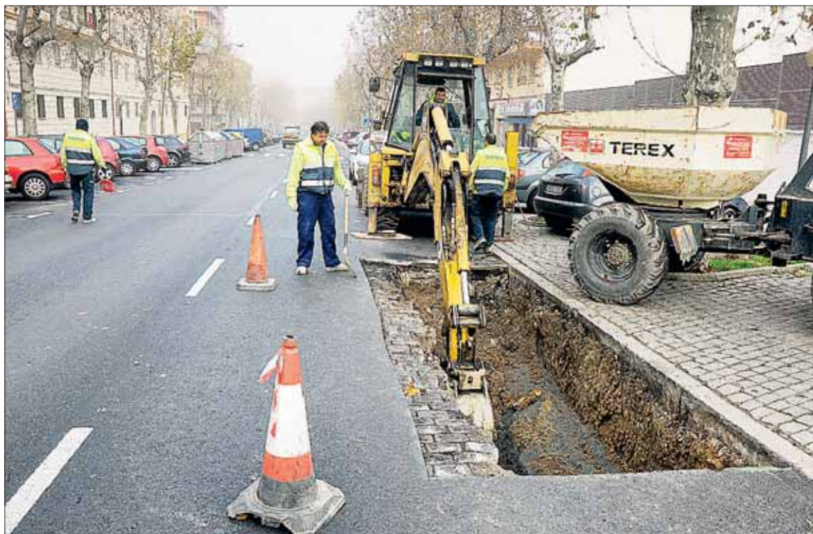
Los trabajos en la avenida de la Constitución continuarán después de las fiestas navideñas para reparar los blandones. / KAMARERO
