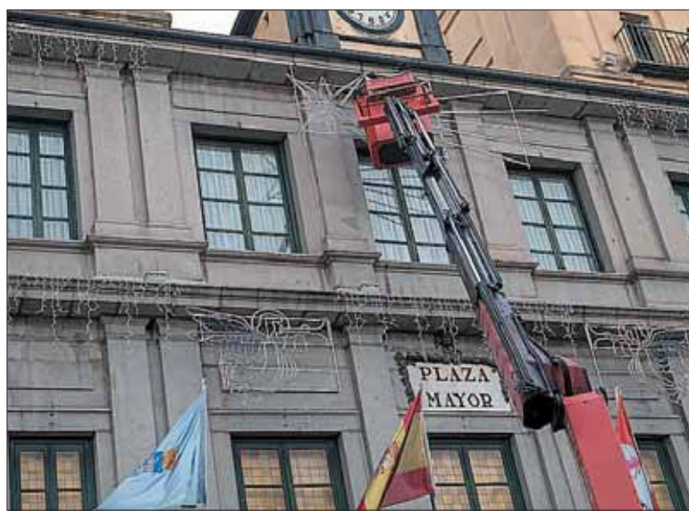
Los operarios ya están instalando las luces por el centro de la ciudad. / KAMARERO
