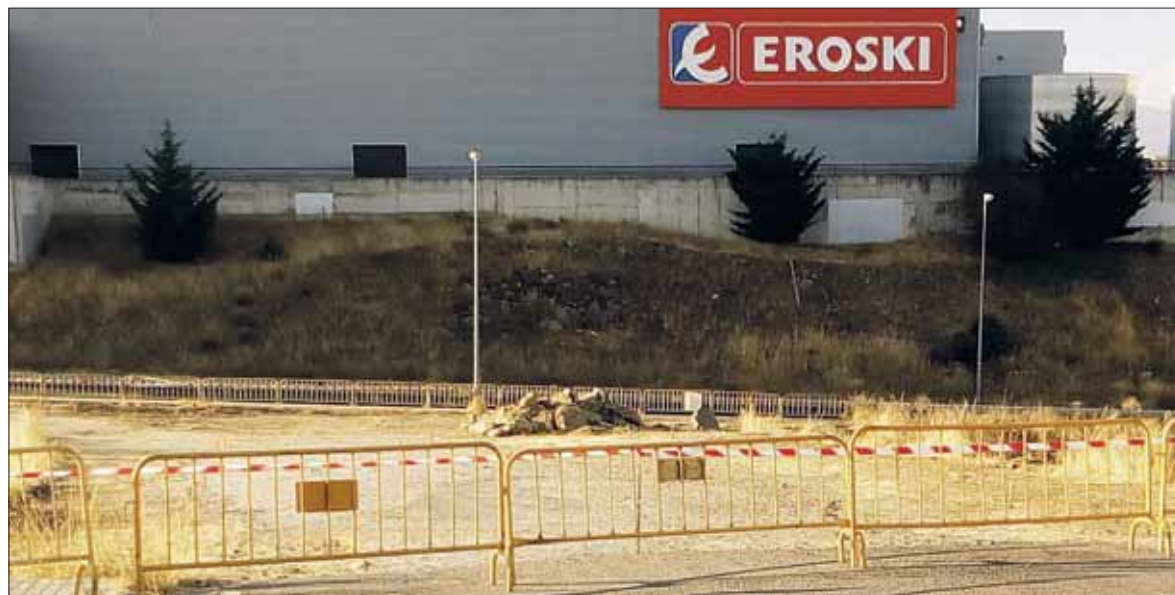
Las primeras obras para ejecutar un nuevo acceso comenzaron recientemente. / EL ADELANTADO
