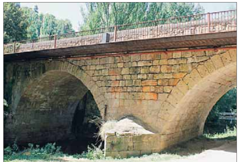
Izquierda Unida alerta de manchas rojizas en el puente de San Marcos. / E. A.
