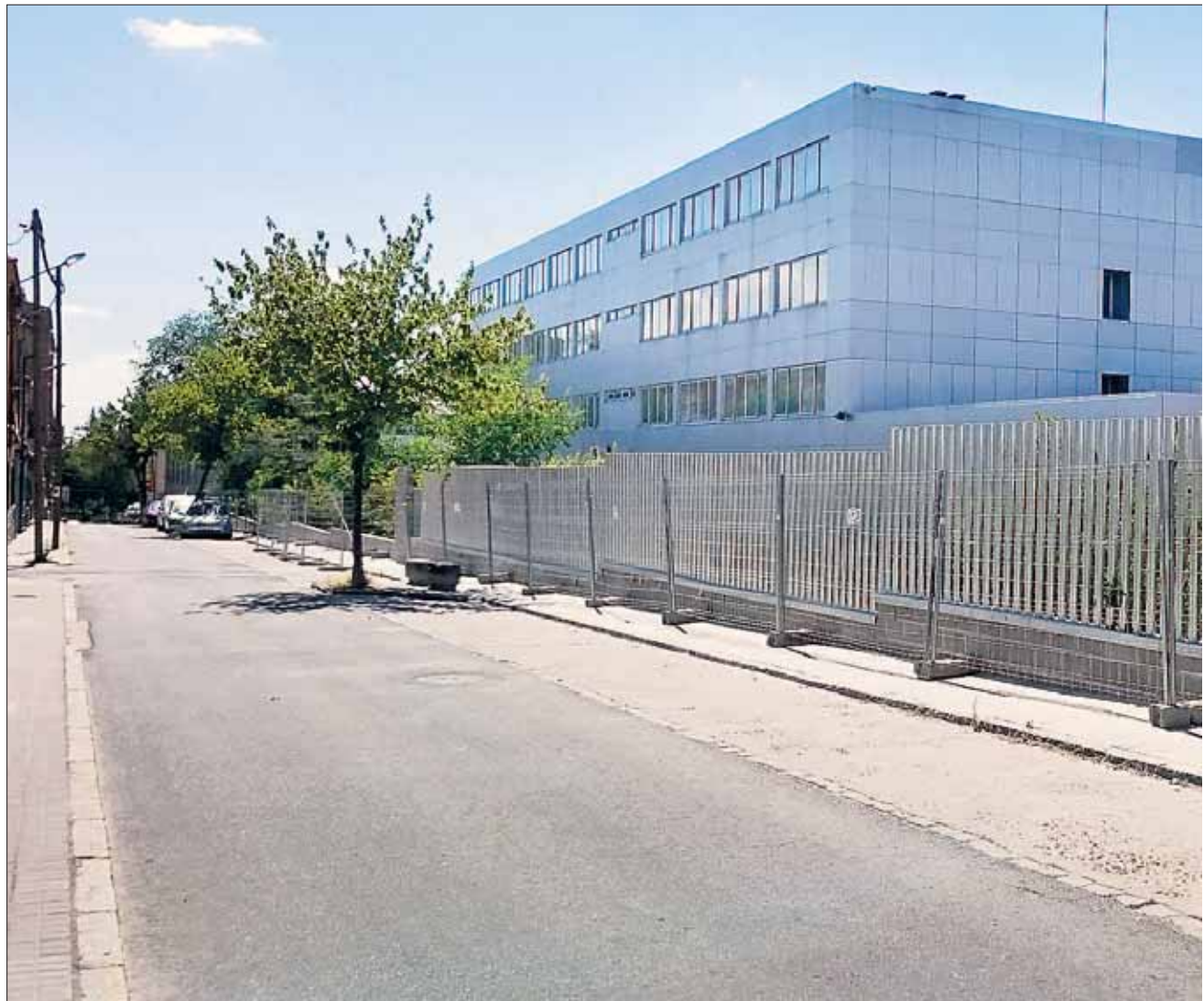
Imagen reciente de la tercera fase de sustitución del vallado exterior del instituto María Moliner que entra en el paquete de obras de Reforma
