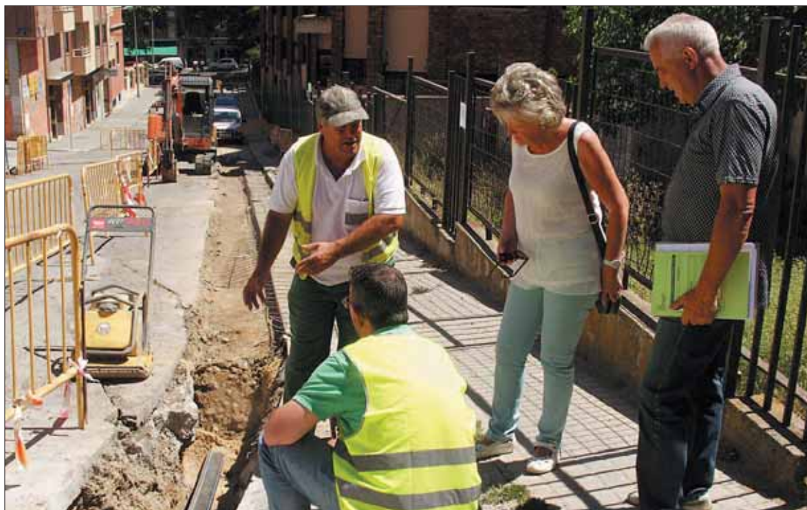
Los operarios municipales trabajan en una de las calles de la parte alta del barrio de Santo Tomás. / EL ADELANTADO
